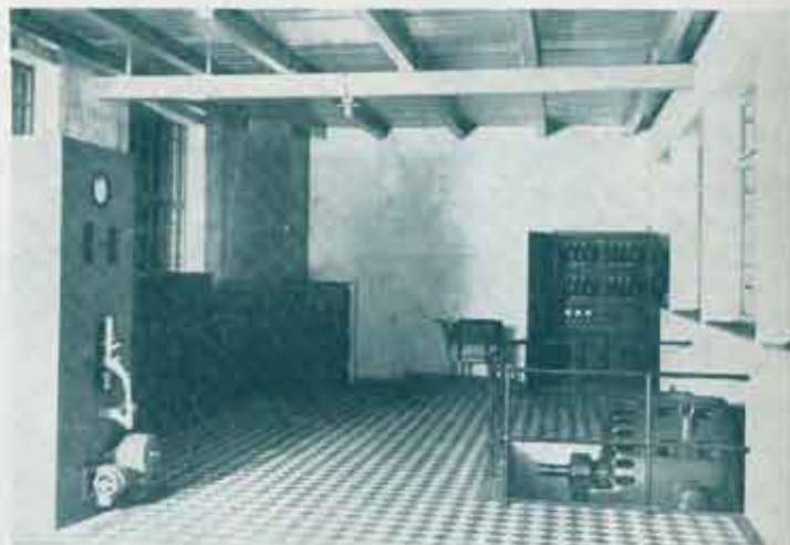
Електромотор (500 Кс) и уклопна плоча.
