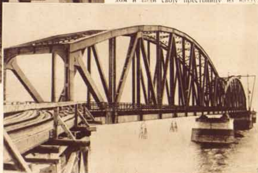
Поглед на прва два лука који су већ монтирани. Обих дана отпочеће монтирање других лука.
